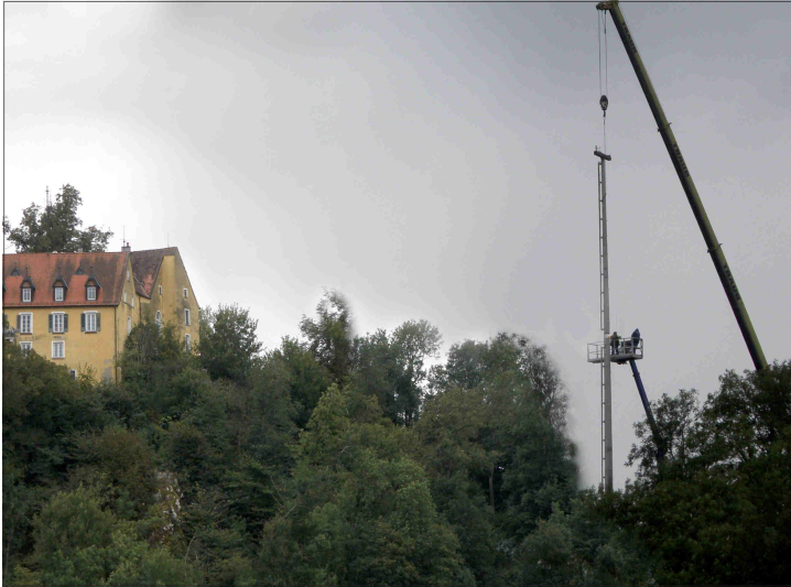
Einsatz in luftiger Höhe: Der Sendemast beim Schlossgut wurde zurückgebaut. Viele verfolgten das Spektakel mit gezückter Kamera.
